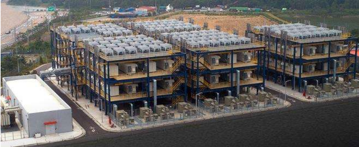
Hình 49: Nhà máy điện pin nhiên liệu sử dụng hydrogen phụ phẩm công suất 50 MW, đặt tại Seosan, Hàn Quốc [10].
