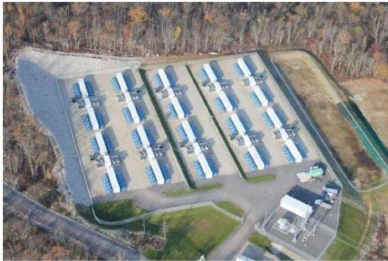
Hình 44: Nhà máy 20 MW của Beacon Power tại xã Hazle, Pennsylvania – Năm 2013
