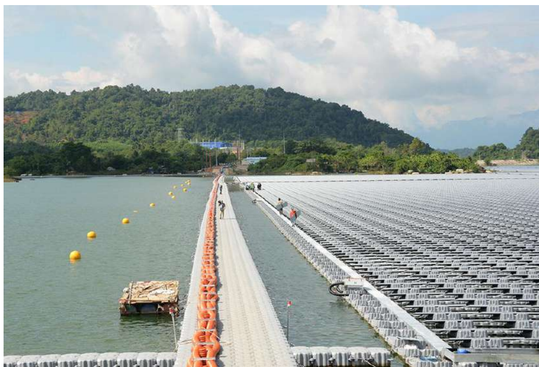
Hình 48: Nhà máy điện mặt trời Đa Mi – 47,5 MWp
