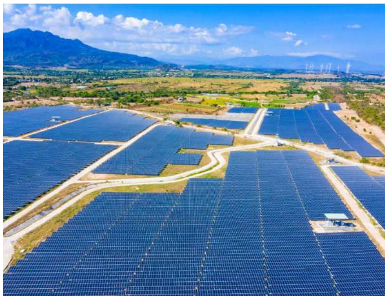
Hình 47: Nhà máy điện mặt trời Trung Nam Thuận Nam – 450 MW
