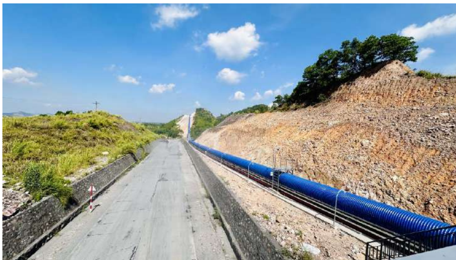
Hình 33: Tuyến băng tải vận chuyển than Tràng Bạch - Mạo Khê
